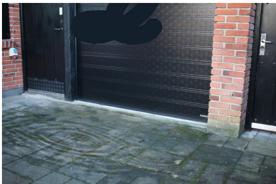
FØR - irriterende vandpytter foran og i garagen.
